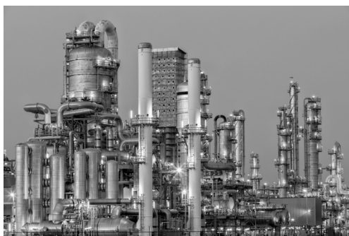
Reservatórios e elementos de tubulação em uma refinaria.
